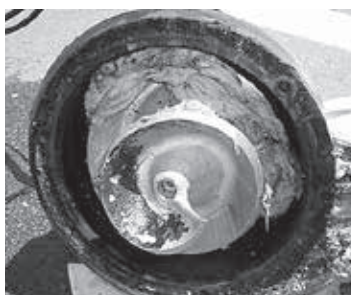
町内で実際にあった下水道の中継ポンプにタオルが絡んで故障した様子
