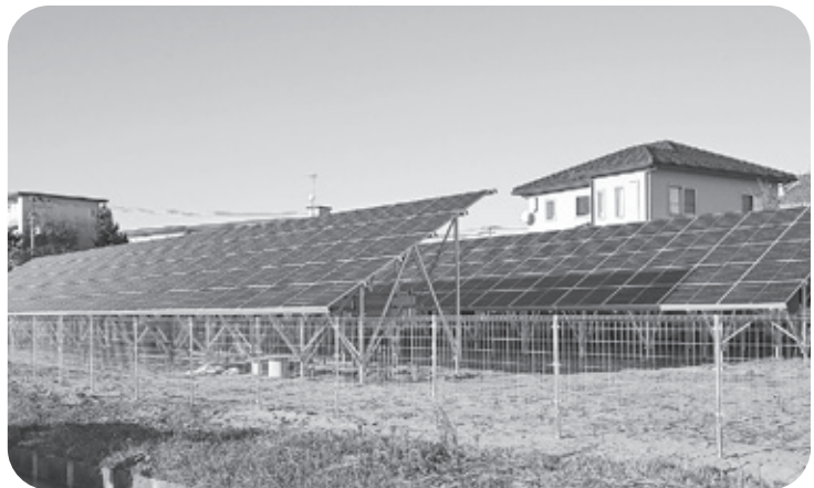
集落内に設置された太陽光発電施設
