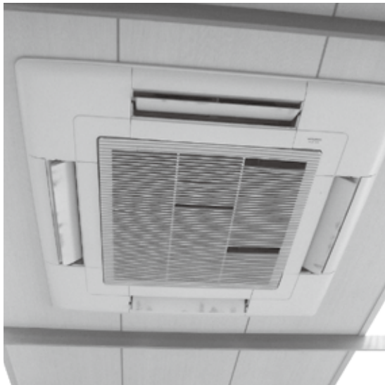
故障中のエアコン
